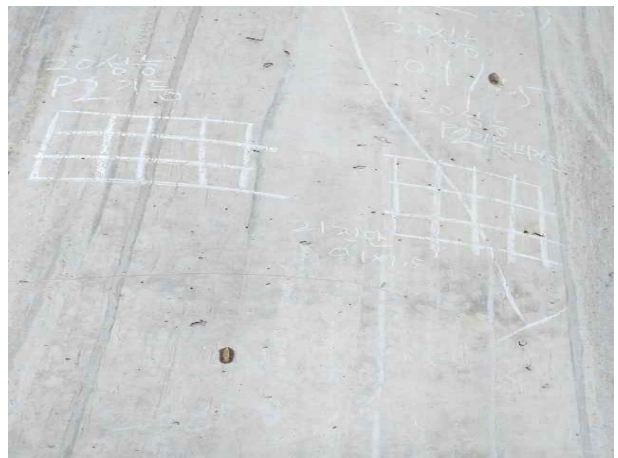
P2 좌측면 균열
