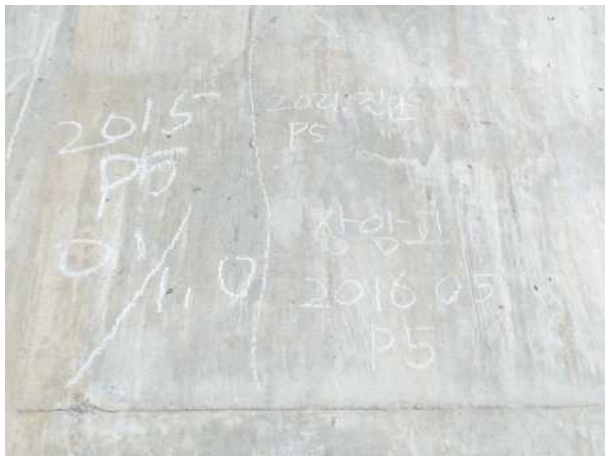
P5 좌 균열
